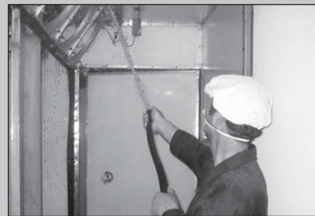
عملیات شستشوی دستگاه ستر در دوره آماده‌سازی
